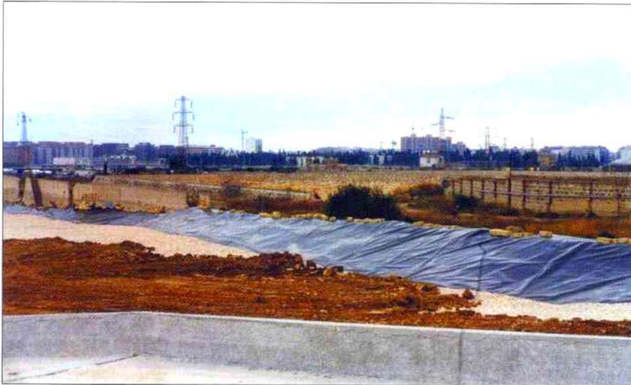
Tav. 8.19 Vasca di landfarming on site realizzata nel sito della ex raffineria Stanic di Bari.
