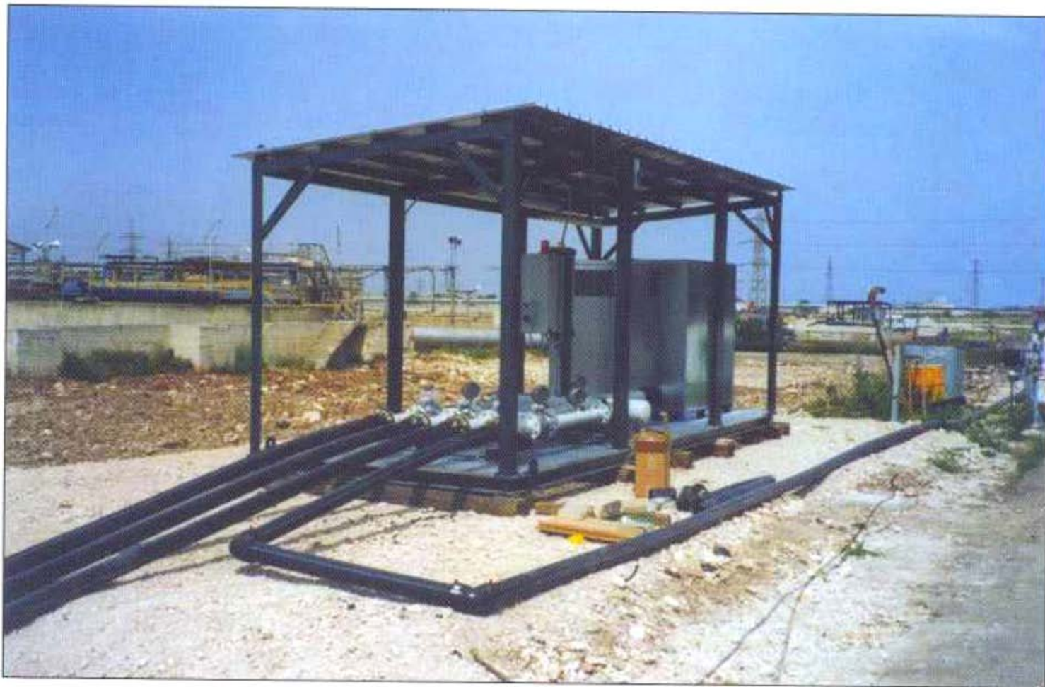
Tav. 8.17 Stazione di bonifica mediante bioventing nel sito della ex raffineria Stanic di Bari.
